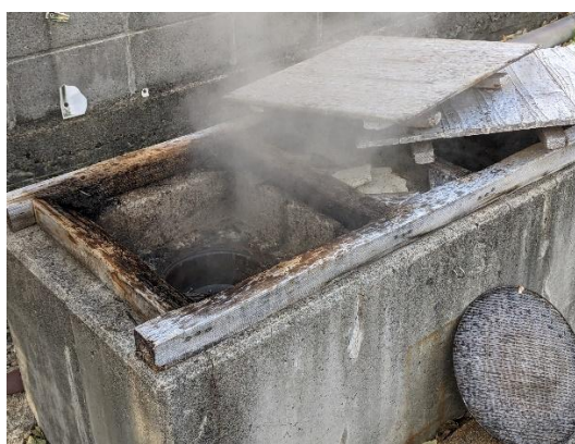
地獄蒸しの設備
