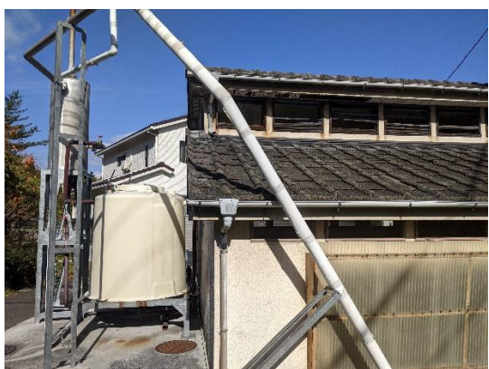
噴気と水で熱交換しカッパータンクに貯めて 給湯を行っている
